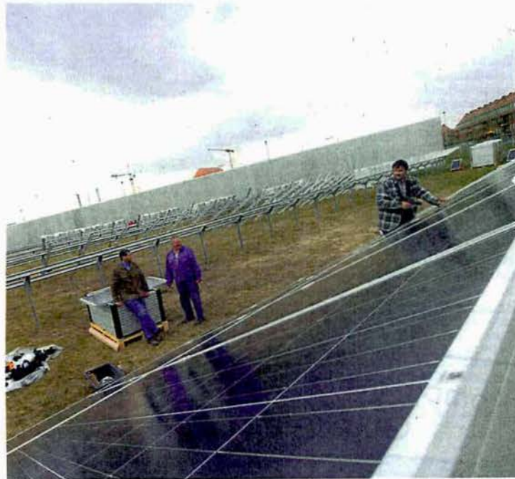
Vor der neuen Gefängnismauer auf dem Görden installieren die Spezialisten die Solarmodule. FOTO: MALO
